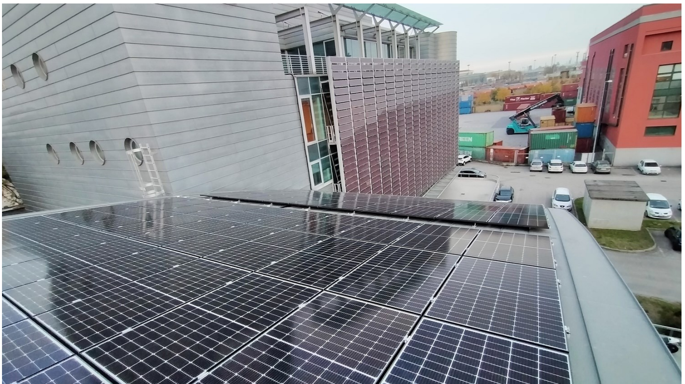
Eine 70-kWp-Solaranlage der ERRECI im Hafen von Marghera bei Venedig.
